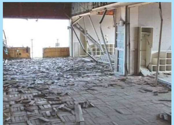
▲木材や鉄骨などが散乱。押し寄せた津波の痕跡が残る
