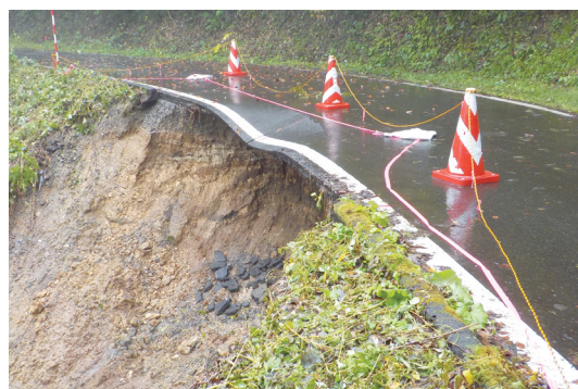
▲町道小山田幹線は通行止め (期間未定)
