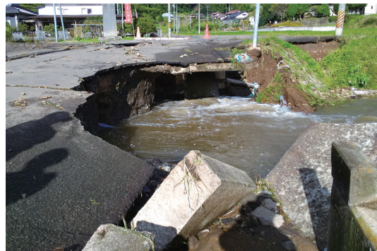
▲堤1区の道路が崩壊 (10/13 (日) 午前8:00)
