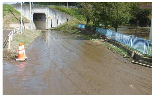
▲水が引き、泥が堆積している西桜1号公園付近 (10/13 (日) 午前11:00)
