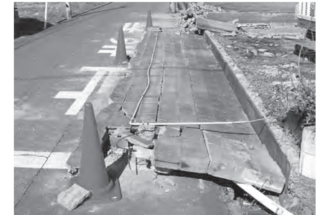
東日本大震災時は町内各所でブロック塀が倒壊
