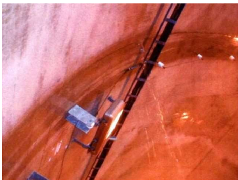
漏水の例 (1) 天井から吹き出し
