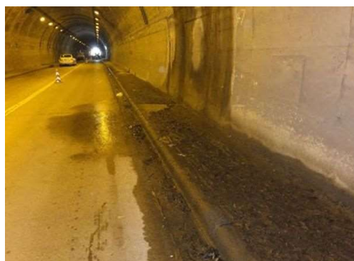
漏水の例 (2) 路面に滞水
