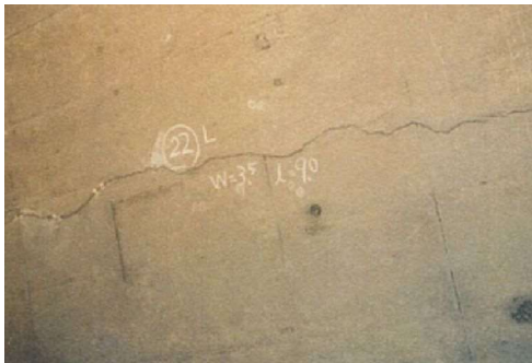
ひび割れの例
