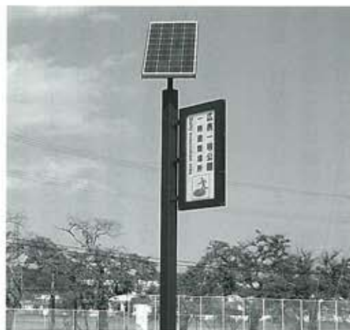
▲太陽光による避難誘導灯
