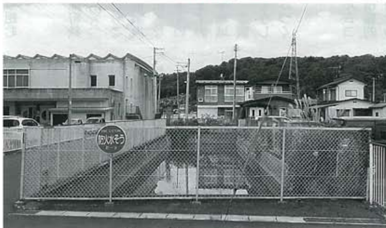
▲老朽化した金ヶ瀬小学校裏の防火水槽
