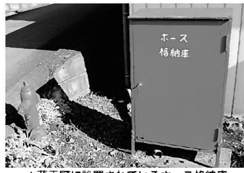
▲蔵王町に設置されているホース格納庫
