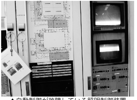
▲自動制御が故障している照明制御装置
