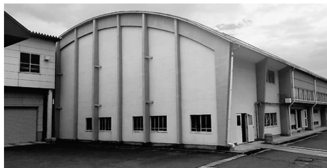
▲築53年が経過し老朽化が激しい大中体育館
