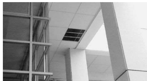
▲天井板が落下した大河原南小学校
