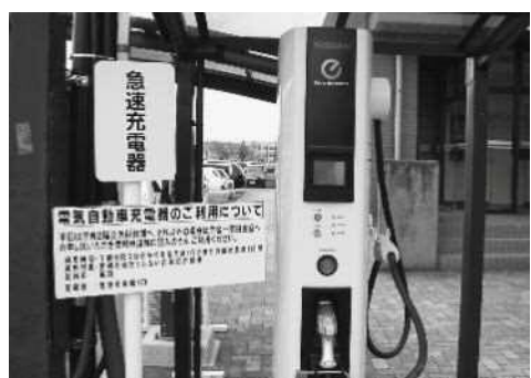
▲急速充電設備
