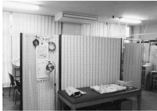
▲大中保健室に設置されたエアコン
