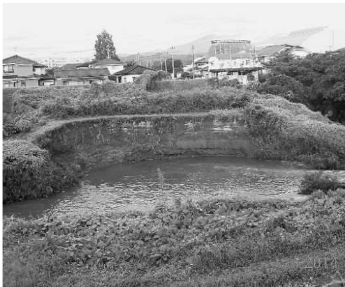
▲大きくえぐられた荒川右岸
