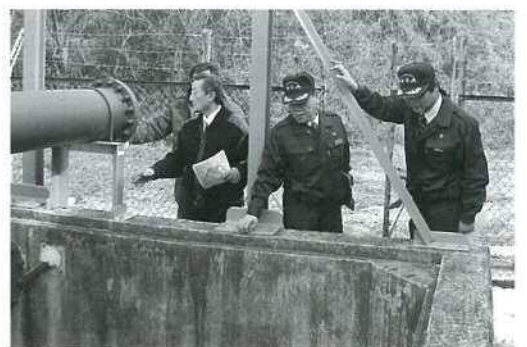
▲稗田地区の第一排水ポンプ
