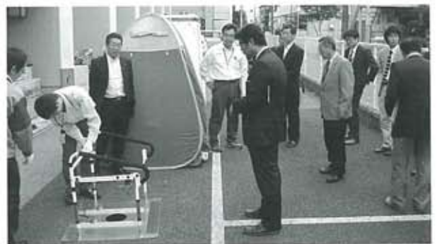
▲下水道直結型のマンホールトイレ(千葉市)
