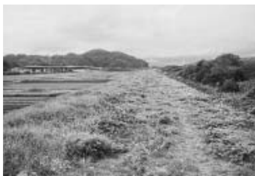
▲整備が望まれる上谷地区右岸堤防
