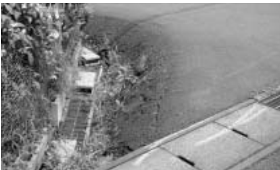
▲注意が必要な道路箇所
