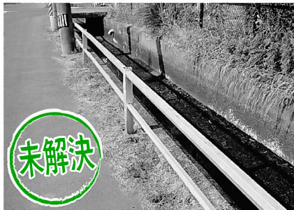
金ヶ瀬小学校裏の柵が低い水路
